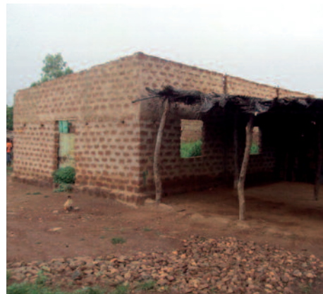
No hubo recursos para más: Muros de la iglesia de Kopoye.
