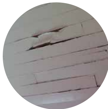
Filtraciones del cielo del templo.
